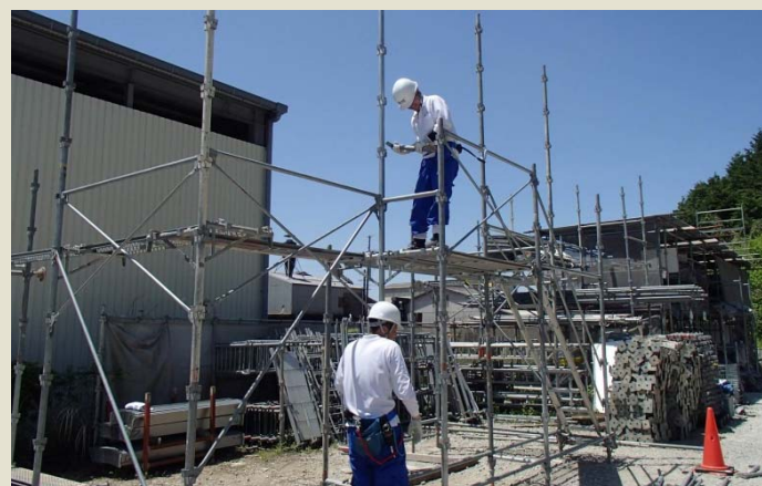
* 作業手順…常に進行方向の墜落防止を設置し作業を進める
